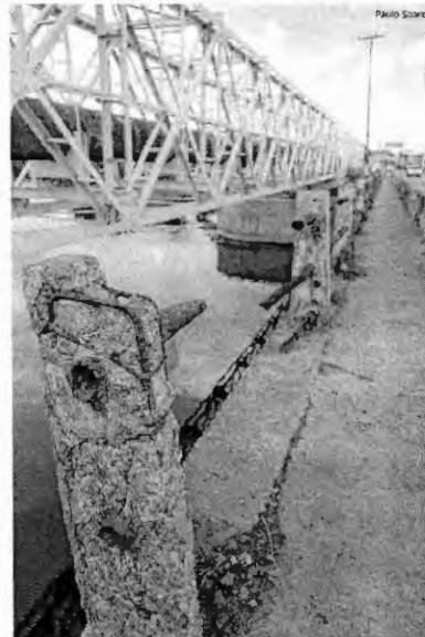
Mureta da Barragem do Bacanga expõe danos causados por ferrugem
