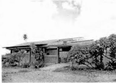
Obra em imóvel que serviu como escola está parada no Bairro de Fátima
