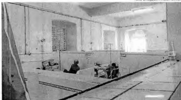
Paredes com mofo e descascadas: ambiente insalubre para mais de 50 pacientes, que ocupam uma das alas
