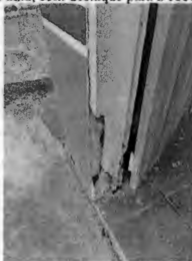
Portas com necessidade de reparos.
