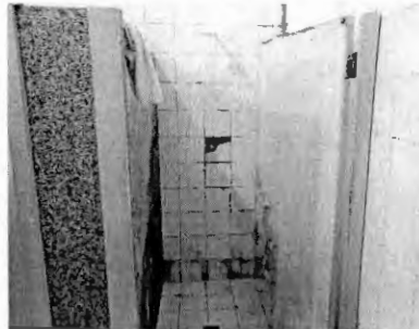
Banheiro em péssimas condições para uso de internos e acompanhantes
