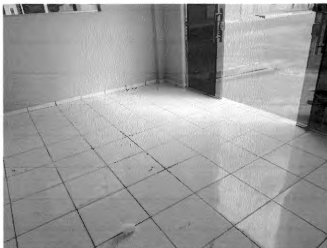
Revestimento cerâmico para piso. No antigo orçamento não havia previsto a troca do revestimento cerâmico.
